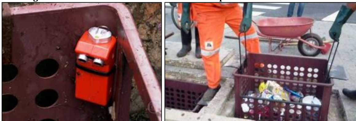
Figura 81 – Sensor em boca-de-lobo instalados pela Prefeitura de São Paulo
