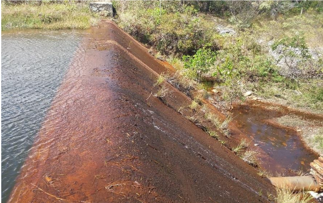
Figura 34 - Face de concreto da Barragem de Moita dos Porcos com surgimento de gramíneas, indicando infiltração de água pelas trincas existentes - Caetité/BA
