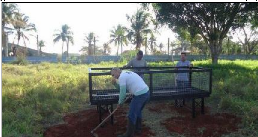
Figura 141 – Lixeira comunitária instalada na zona rural de Tupã/SP
