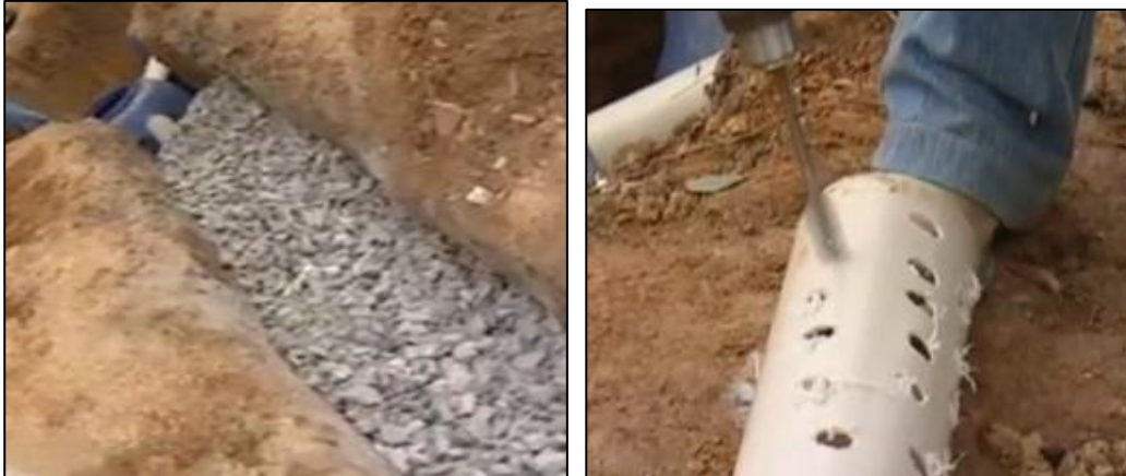
Figura 61 – Vala de infiltração para disposição do efluente da fossa econômica
