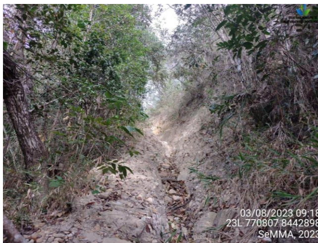
Imagem 20: Erosão na trilha, próximo à APP da Nascente do Riacho Pedreira.
