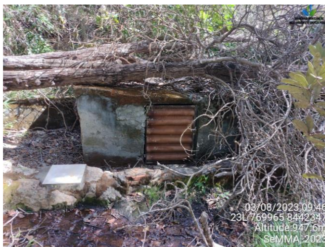
Imagem 16: Casa de bomba instalada no limite da APP da nascente para captação de água do Riacho Pedreira.
